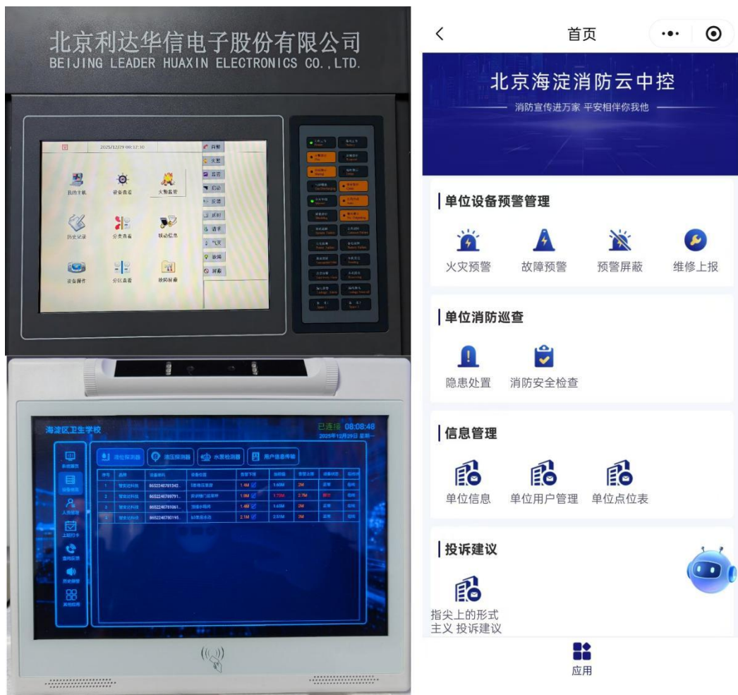
图 6-7 学校消防“三水一电”云监控智能巡查系统，接入海淀区城市大脑
